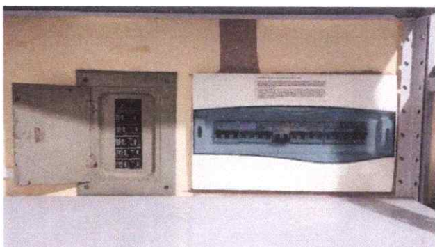
Imagem 09: Quadro de distribuição.
